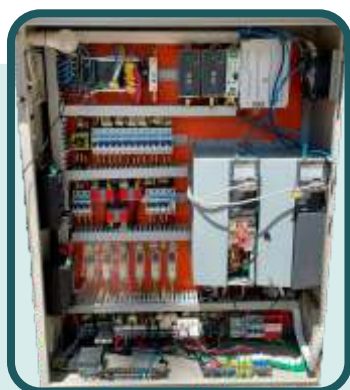
Automação de estação elevatória COPASA
