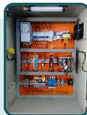
Sistema de Lubrificação de Mancais EMBASA
